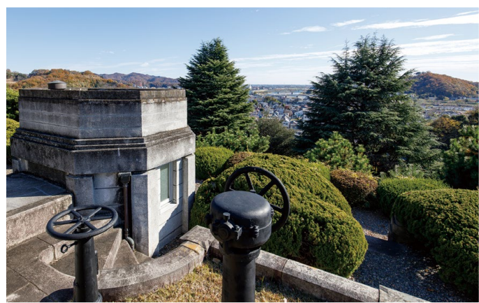
配水池からの眺望。 施設の石段を上ると足利市が一望できる
