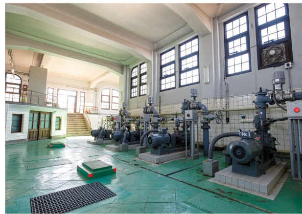
今福浄水場ポンプ室内部。地下から汲み上げた水を減菌し、緑町配水場に圧送する
