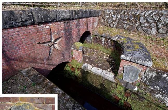
星型のマークが象徴的な鳴沢川取水口。星型はこの地に工場を建設した下野製麻株式会社の社標である
