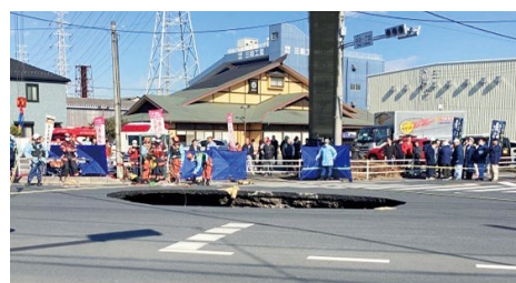
陥没発生直後、 交差点の陥没穴
